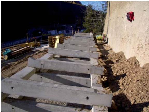
Bild 5: Raumgitterwand, A9 Pyhrnautobahn bei Objekt PY 68.1 Teichlbrücke, Verlegebeginn Wandtype RGW 270/2-5. Foto: Walter Herzog
