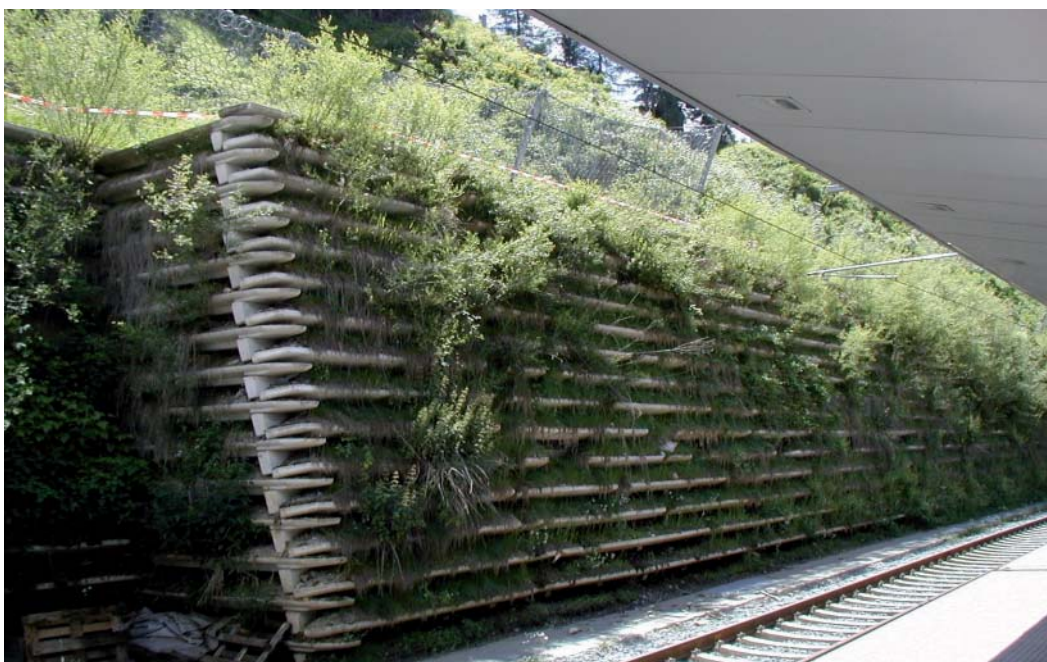
Einsatz im Bahnbe- reich: neuer Bahnhof St. Anton
