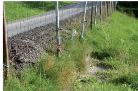
Bisherige Sanierung der Absetzungen durch Aufkeilung des talseitigen Randes mit Profilmischgut, Stärke insgesamt bis zu 80 cm
