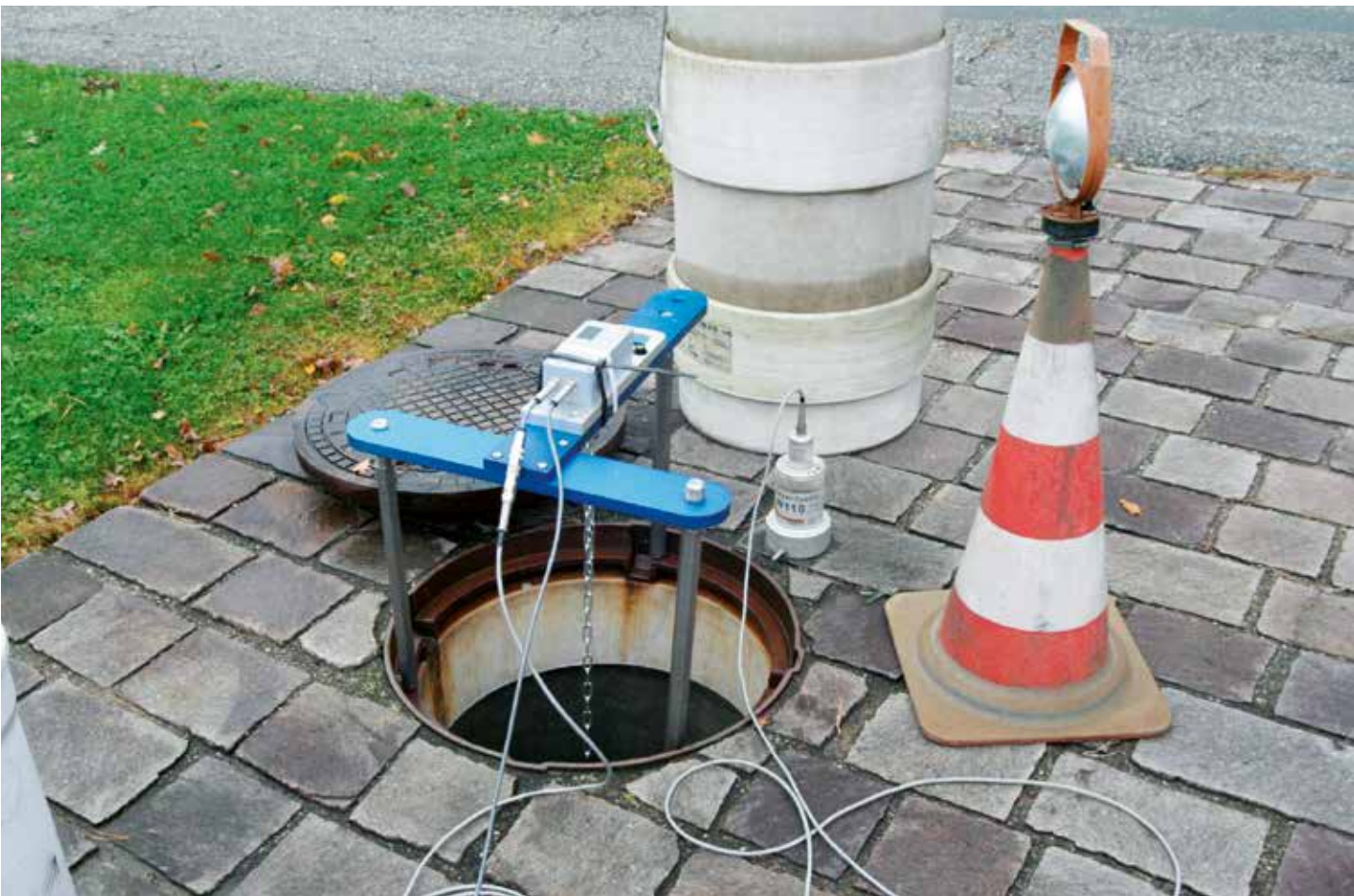
Schachtprüfung gemäß Pkt.: 6.5.4
