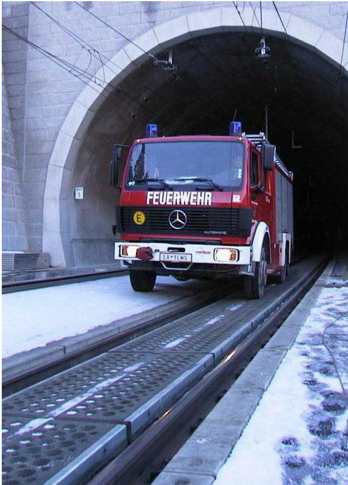
Lärmschutzabsorber-Elemente im Gleisbereich an Westbahnstrecke bei ST. ANTON/Arlberg (Foto RIEDER)
